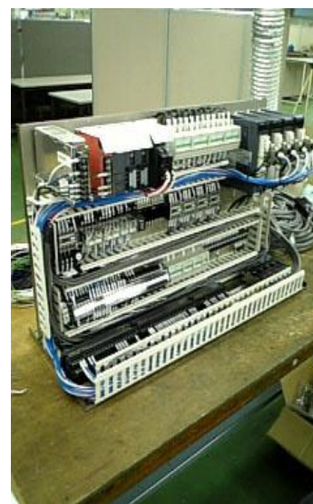
半田自動供給装置制御盤
