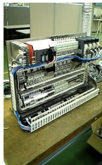
半田自動供給装置制御盤
