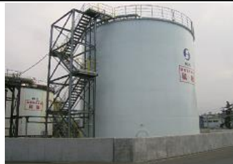
2600T 硫酸タンク設備
